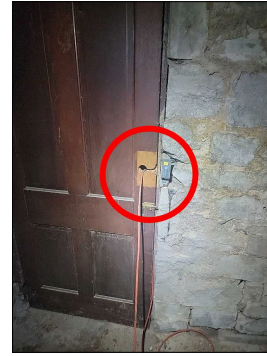
Door Knob Missing: Basement Door
